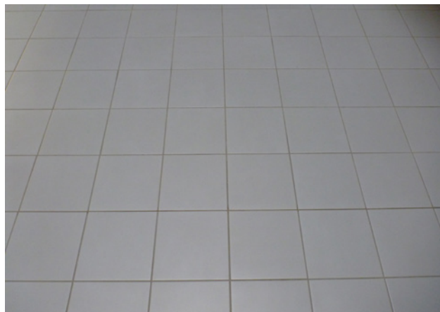
1 La colla delle piastrelle posate prima del 1990 può contenere amianto.
