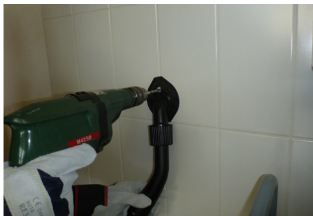
4 Utilizzo del trapano con aspirazione alla fonte su piastrelle con colla contenente amianto
