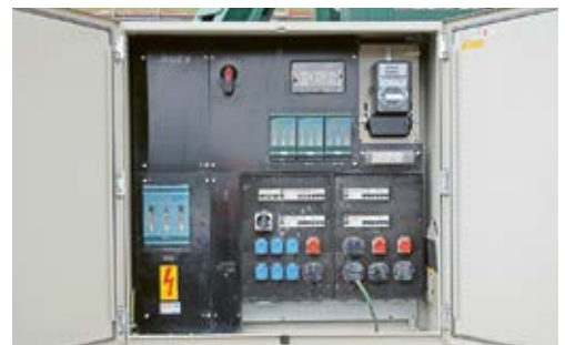
5 Le raccordement des distributeurs de chantier doit être confié à des installateurs agréés.
