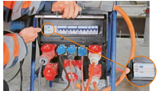
6 Tableau de chantier avec dispositif différentiel à courant résiduel (DDR). Contrôler les fonctionnalités de l'interrupteur différentiel DDR (avant le début du travail, selon les indications du fabricant).
