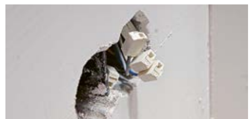
8 Câbles isolés dépassant d'un mur.
