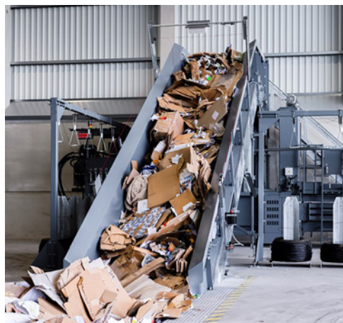
2 Pressa compattatrice con transponder capace di rilevare persone in avvicinamento posto al di sopra del convogliatore.
