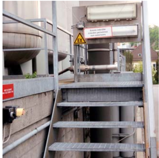
23 Les sources d'inflammation sont interdites dans les zones à risque d'explosion; ces dernières doivent être signalisées par un panneau d'avertissement «EX» approprié.
