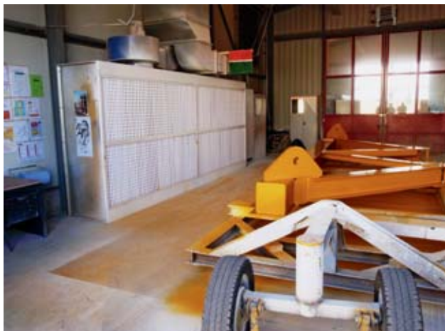
17 Paroi aspirante pour effectuer des travaux occasionnels de giclage de peinture dans une grande halle
