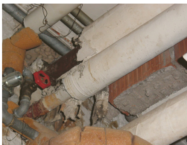
1 Isolation de tuyau avec mortier amianté.
