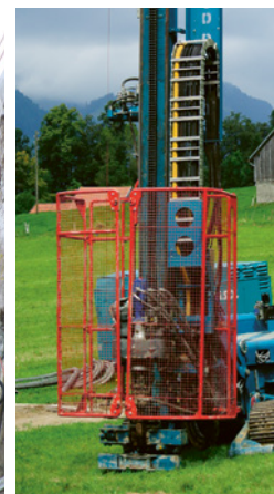
4 Les foreuses mises sur le marché dès le 10 mars 2015 doivent être équipées de protections enveloppantes, par exemple des cages métalliques.
