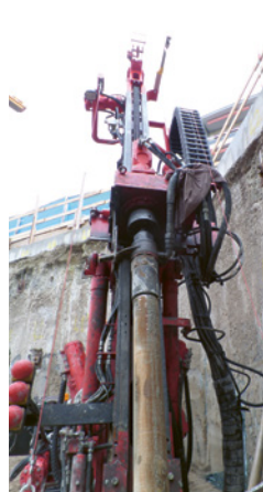
3 Les foreuses mises sur le marché avant le 10 mars 2015 doivent être équipées de dispositifs sensibles des deux côtés du train de tiges, par exemple au moyen de câbles de sécurité.
