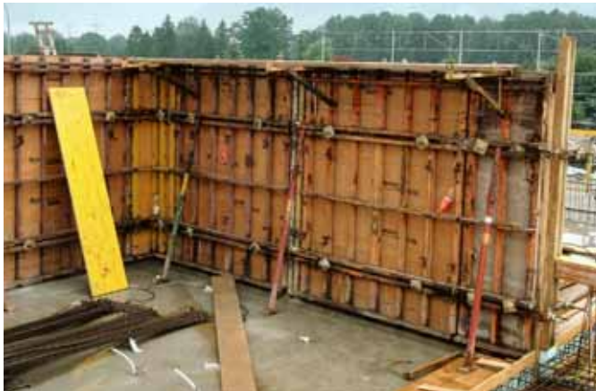
01 // Falsch: Von diesem Konsolgerüst stürzten die beiden Arbeiter auf den Betonboden. Auch der Seitenschutz fehlte. // Bild: Suva
