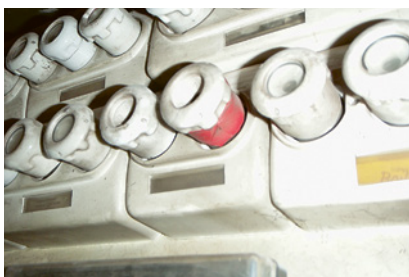
1 Defekter Keramikkörper. Es besteht Gefahr, sich zu elektrisieren.
