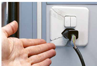
2 Beschädigte Abdeckplatte und defektes Kabel. Es besteht Elektrisierungs-Gefahr.
