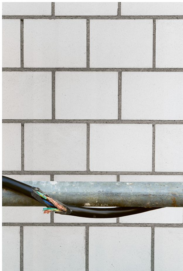
16 Defekte Kabel und Geräte einzusetzen lohnt sich nicht.
