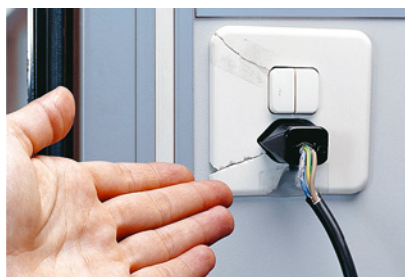
2 Beschädigte Abdeckplatte und defektes Kabel: Elektrisierungsgefahr
