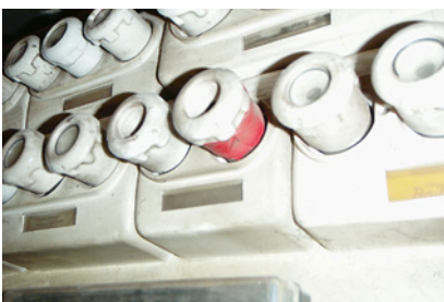
1 Defekter Keramikkörper: Es besteht Elektrisierungsgefahr.
