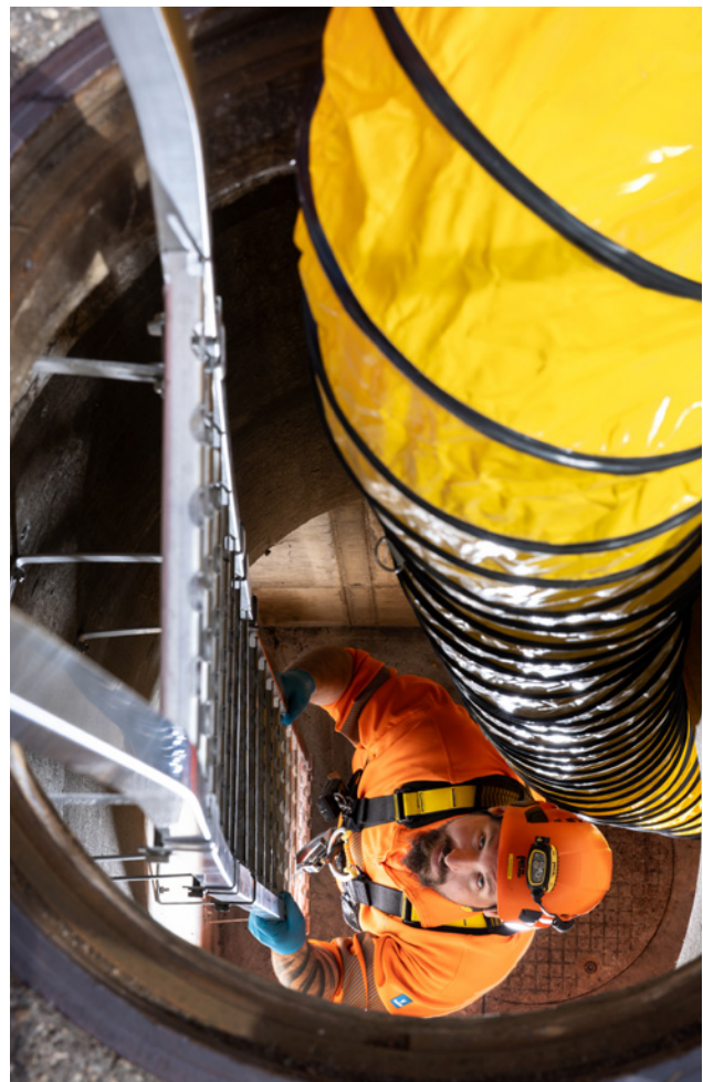
8 Die künstliche Lüftung ist so lange in Betrieb zu halten, wie sich Personen in den Schächten und Gruben aufhalten.
