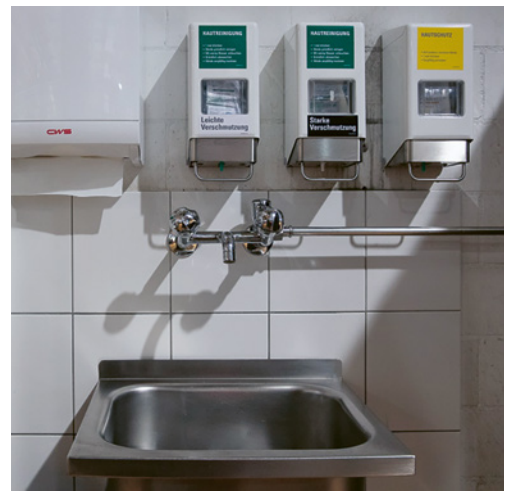
5 Stazione di lavaggio fornita di adeguati detersivi.
