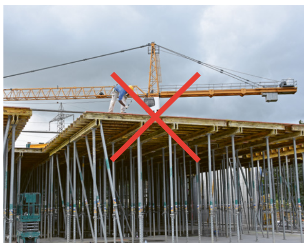
2 Verboten: Deckenschalung ohne Absturzsicherung bei grosser Absturzhöhe.
