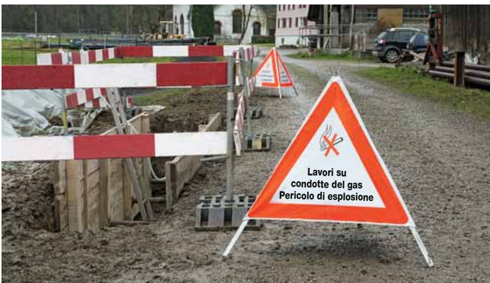
Figura 20 Sbarramento con segnale di pericolo
