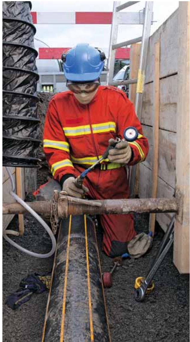
Figura 27 Ventilazione artificiale in uno spazio ristretto
