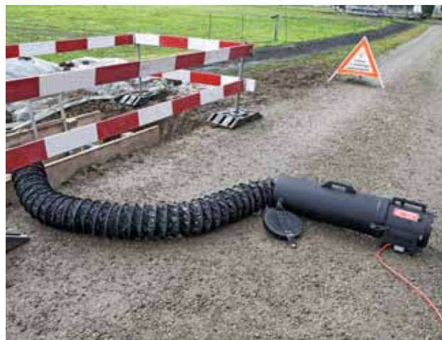
Figura 17 Ventilatore con tubo di aspirazione
