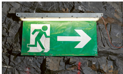
2 Segnaletica per le vie di fuga
