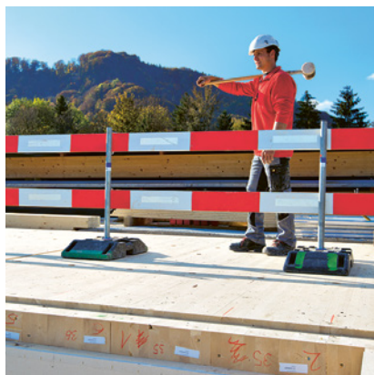
1 Barrière de protection: 2 m avant la zone à risque de chute
