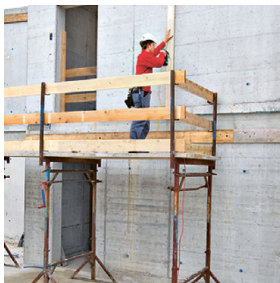
2 Échafaudage à chevalets avec garde-corps correct
