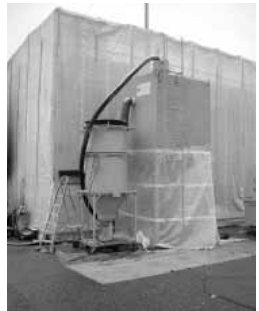
Bild 2: Absaug- und Entstaubungsanlage, Einhausung mit leichtem Unterdruck.
