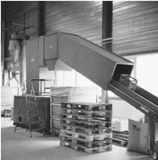
Figure 20: Broyeur de matière plastique pour harasses à boissons usagées. La bande transporteuse pour l'acheminement du produit à broyer (à droite) est conçue comme un amortisseur de bruit. Le granulat obtenu est aspiré par l'intermédiaire d'un tuyau. L'enceinte est constituée à l'extérieur par une tôle d'acier de 1,5 mm d'épaisseur et à l'intérieur par de la laine minérale de 50 mm et une tôle perforée.
