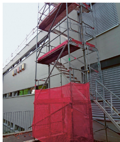
12 Torre scala per ponteggio
