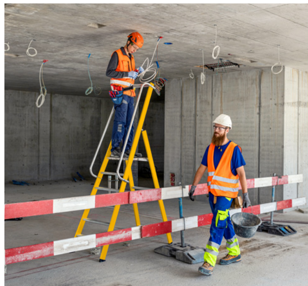
3 Messa in sicurezza della scala in prossimità di vie di circolazione
