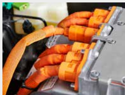
Orange Leitungen als Hinweis auf Hochvoltssysteme
