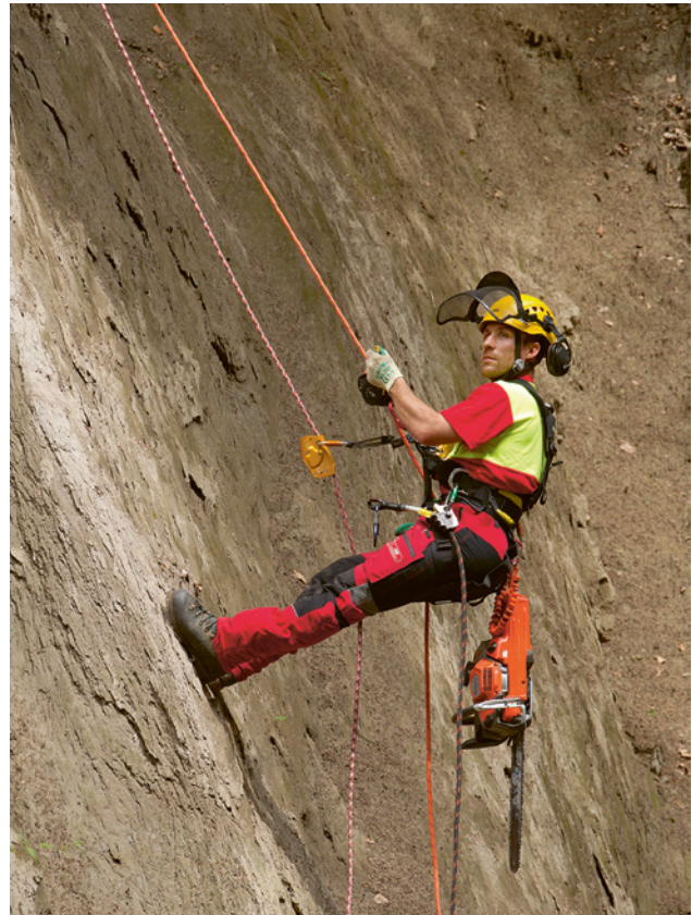
2 Per i lavori in sospensione a corde portanti occorre una formazione supplementare.
