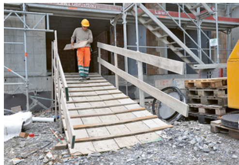
7 Accesso sicuro al cantiere grazie alle protezioni laterali e ai puntoni trasversali. Gli accessi al cantiere devono essere larghi come minimo 1 m.
