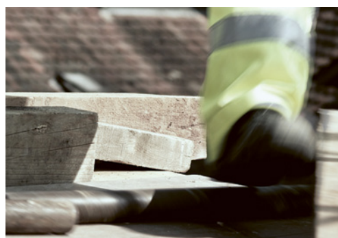
2 Occorre eliminare i pericoli di inciampo.
