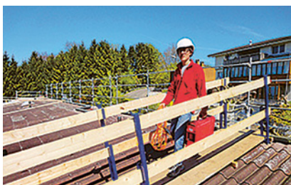
1 Wellplattendach aus Faserzement, mit Laufsteg gesichert.
