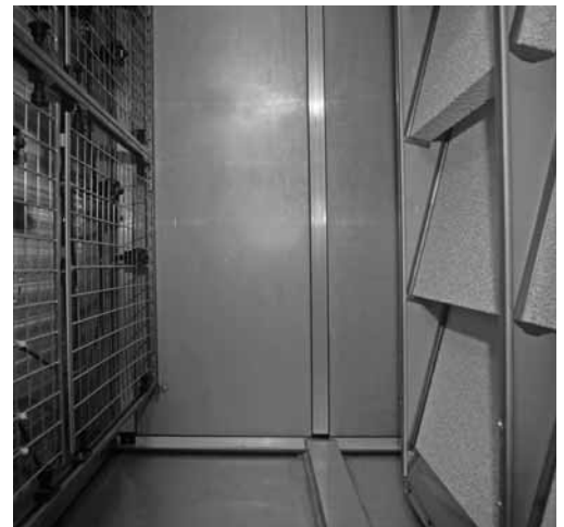
Einblick in einen Hybridbefeuchter. Der Hygienezustand muss regelmässig überprüft werden.
