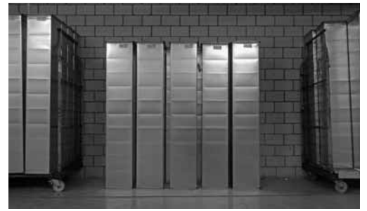
Luftkanäle vor Einbau, geordnet und sauber gelagert.
