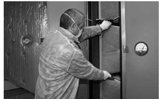
Filter müssen regelmässig gewechselt werden.
