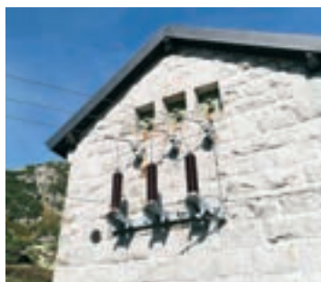
In quota i droni possono verificare eventuali danni agli isolatori da 16 kV.
