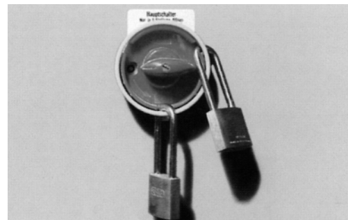
Figura 10: Interruttore di sicurezza. Per evitare che terzi possano mettere in moto i nastri trasportatori durante i lavori di manutenzione, gli interruttori di sicurezza sono da chiudere a chiave mediante un lucchetto personale.
