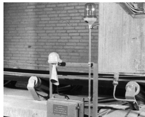
Figura 11: Dispositivo di avvertimento della messa in moto dell'impianto. A seconda della situazione si può ricorrere a segnali acustici od ottici, in certi casi anche a tutte e due combinati.
