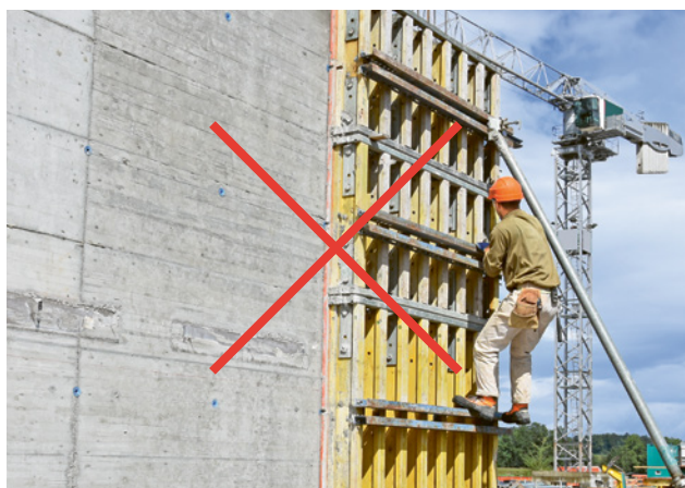
5 Interdiction d'escalader des éléments de coffrage de murs!
