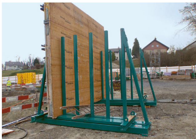
4 Râtelier utilisé pour l'entreposage vertical.
