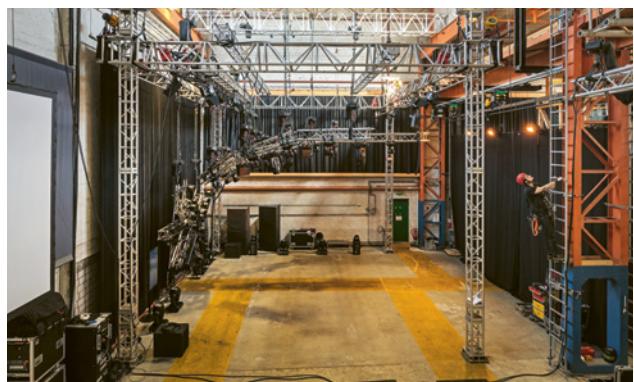
2 Veranstaltungsriggering in einer Halle
