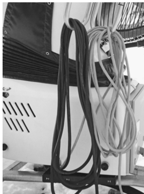
Fig. 5: les câbles non nécessaires sont enroulés.
