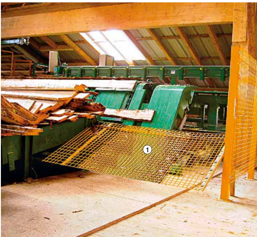
Bild 31: Ausführungsbeispiel einer abweisenden Schutteinrichtung als Teil der Zugangssicherung zum Gefahrenbereich einer Vereinzelung
