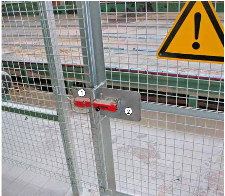
Bild 35: Elektrisch verriegelte Zugangstür
