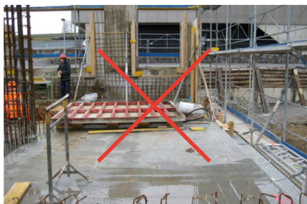
4 Un montatore operante nella parte superiore della casseratura è stato travolto dalla caduta di un modulo. È assolutamente vietato usare i puntelli per solette per sostenere i casseri!
