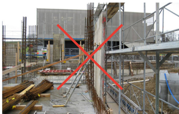
3 Modulo non resistente alle forze di trazione e compressione; struttura non conforme perché sostenuta da due puntelli per solette.
