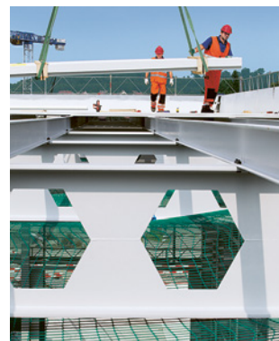
Regel 8 Absturzsicherung mit Kollektivschutz
