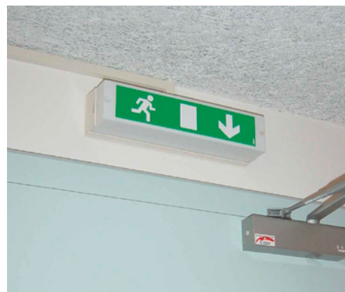
6 Esempio di illuminazione di emergenza
