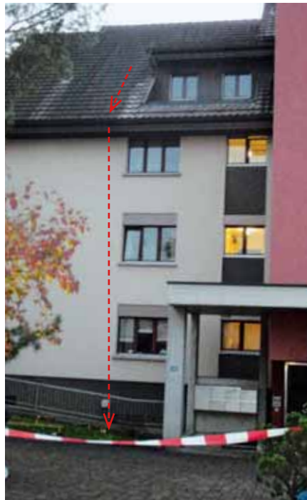
01 // Le peintre était en train de poser le revêtement extérieur à la lucarne lorsqu'il a glissé avec l'échelle de couvreur et s'est écrasé sur la pelouse.
