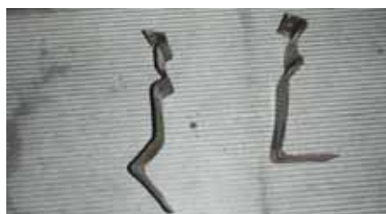
03 // Les arrêts de neige ont été déformés et arrachés en raison de la charge supérieure à celle autorisée. // Photos: Suva
