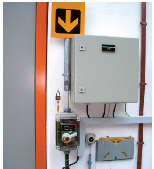
5 Interrupteur pouvant être verrouillé en position déclenchée, afin d'éviter toute mise en marche intempestive du pont roulant.
