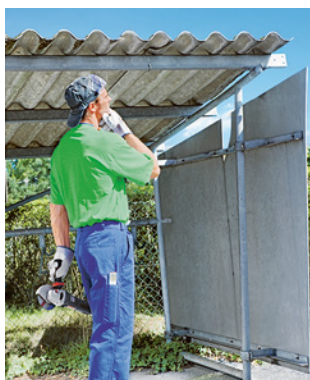
Regola 7 Proteggersi dalle polveri di amianto
