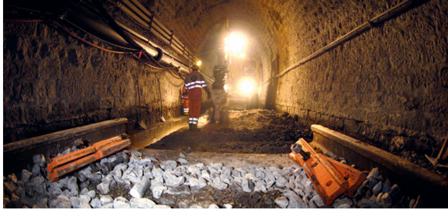
On mesure des concentrations élevées d'oxydes d'azote, p. ex lors de la rénovation de tunnels ferroviaires anciens et étroits. (Source: Emch et Berger)
