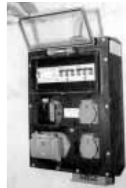
Stromverteiler mit Fehlerstromschutzschalter. Für Installationen ausserhalb von Gebäuden muss eine Fehlerstromschutzschaltung verwendet werden.
