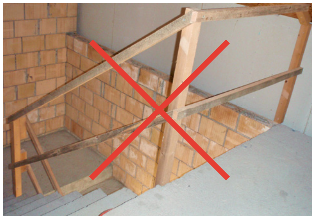
2 Vietato utilizzare i listelli per tetti come elementi della protezione laterale (foto scattata in un vano scala).
