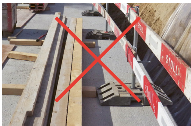
6 Usare dei basamenti in gomma per la protezione laterale sui bordi delle solette è vietato in quanto la protezione laterale può facilmente ribaltarsi.
