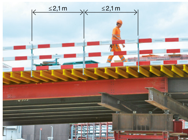
1 Protezione laterale realizzata con tavole di sbarramento bianco-rosse: distanza massima tra i montanti 2,1 m.
