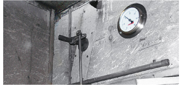
Conduit d'aération avec plaques en fibrociment
