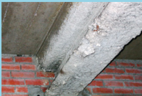
Isolation à base d'amiante floqué
