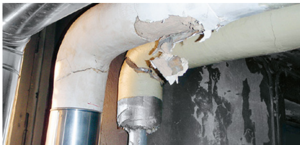
Tuyau avec mortier amianté
