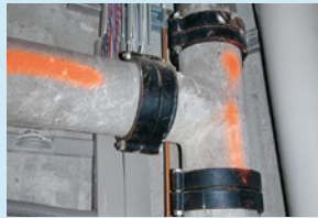
Tuyaux en fibrociment
