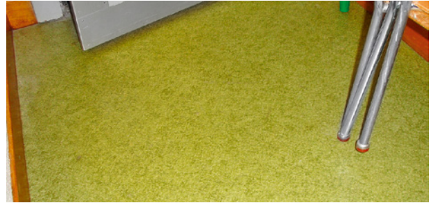
Revêtements de sols multicouches amiantés; cushion vinyl
