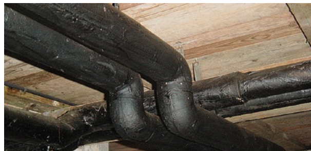
Revêtement bitumineux amianté
