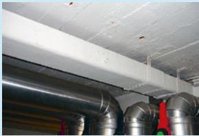
Chemin de câbles en fibrociment
