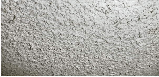
Crépi acoustique amianté
