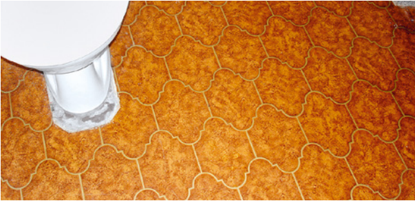
Revêtements de sols multicouches amiantés; cushion vinyl
