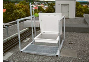
3 Accesso sicuro al locale macchine
