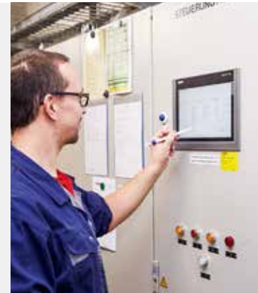
Steuerung der Raumtemperatur
