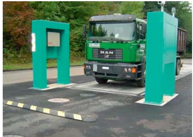
18 Ortsfeste Messportale bei einem Wareneingang
