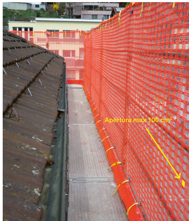
1 Parete di protezione da copritetto corretta e testata secondo la norma SN EN 13374 con rete che delimita il ponte da lattoniere e cinghie di fissaggio.
