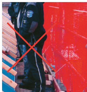
5 La polizia e le autorità inquirenti indagano sulla causa di un infortunio: la parete di protezione da copritetto è difettosa e fissata in modo non corretto usando fascette serracavo.
