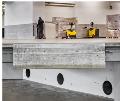
6 Pont de chargement fixé sur un rail
