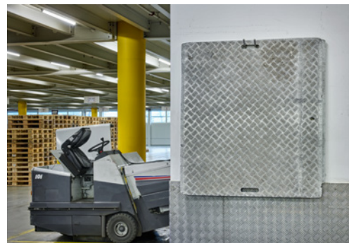
5 Pont de chargement fixé au mur
