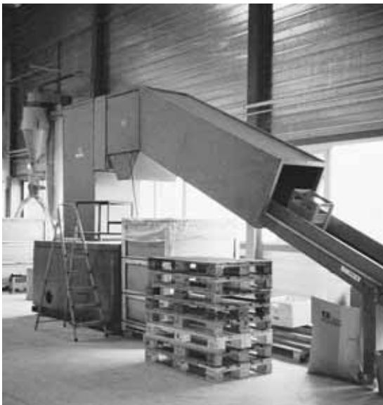
Bild 20: Kunststoffmühle für gebrauchte Getränkeharassen. Das Förderband für den Transport des Mahlgutes (rechts) ist als Schalldämpfer ausgebildet. Das entstandene Granulat wird über eine Rohrleitung abgesaugt. Die Kapselung besteht aussen aus 1,5 mm dickem Stahlblech, innen aus 50 mm Mineralwolle und Lochblech.
