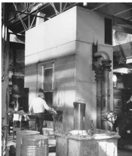
Bild 37: Gesamtansicht der gekapselten Gesenkschmiedepresse.
