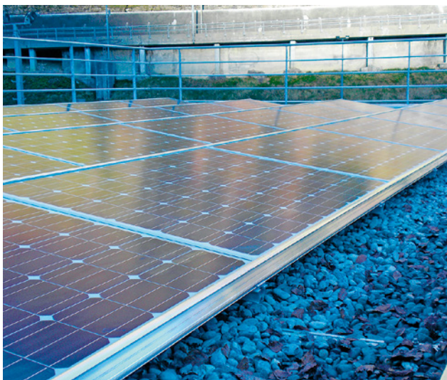
5 Impianto solare su tetto piano con parapetto perimetrale fisso.
