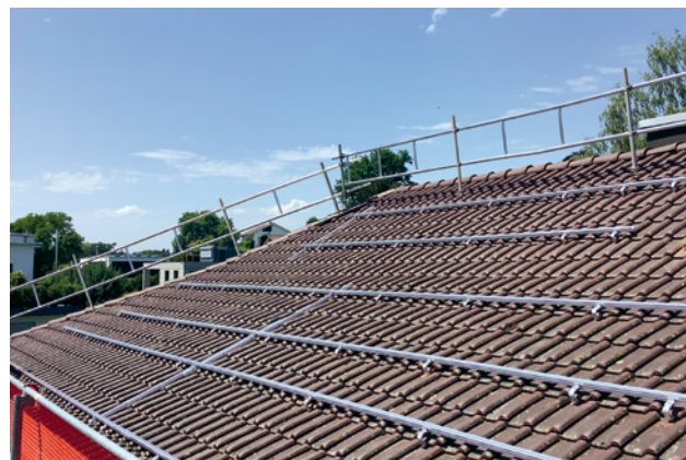
3 Una protezione laterale sul colmo evita le cadute dalla falda del tetto su cui non si lavora.
