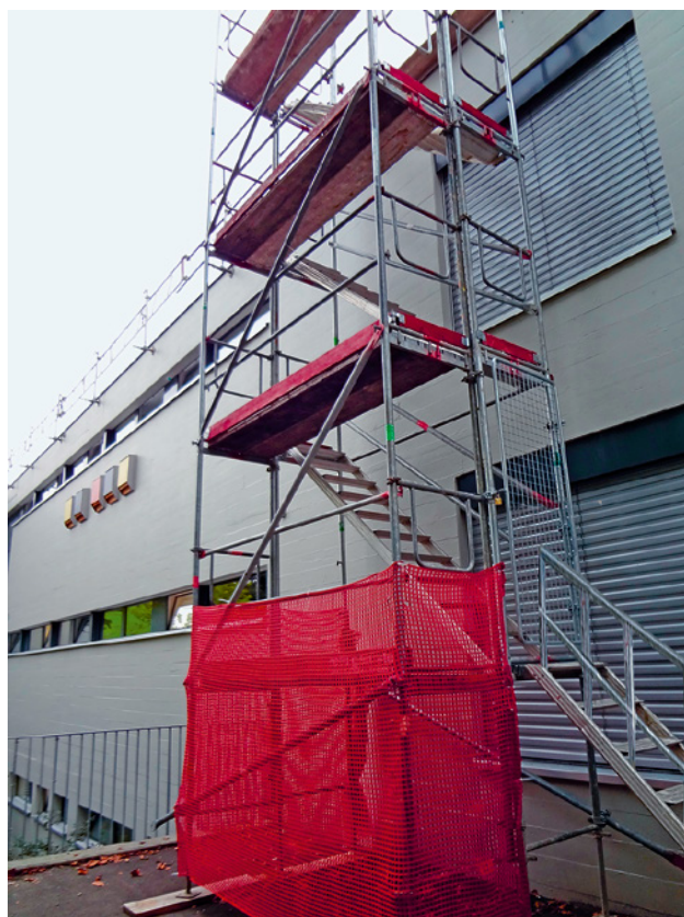
4 Accesso sicuro tramite una torre scala
