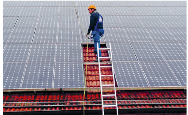
15 Fune tirata oltre il tetto e ancorata, con dispositivo anticaduta di tipo guidato
