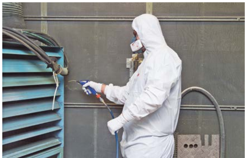
Bild 6 Druckluft ist zur Reinigung nur zulässig, wenn es technisch keine andere Möglichkeit gibt und die Arbeit bei laufender Kabinenabsaugung ausgeführt wird.
