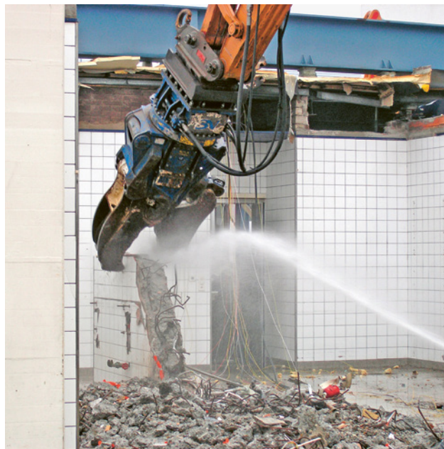
Piastrelle ceramiche contenenti colla a base di amianto
