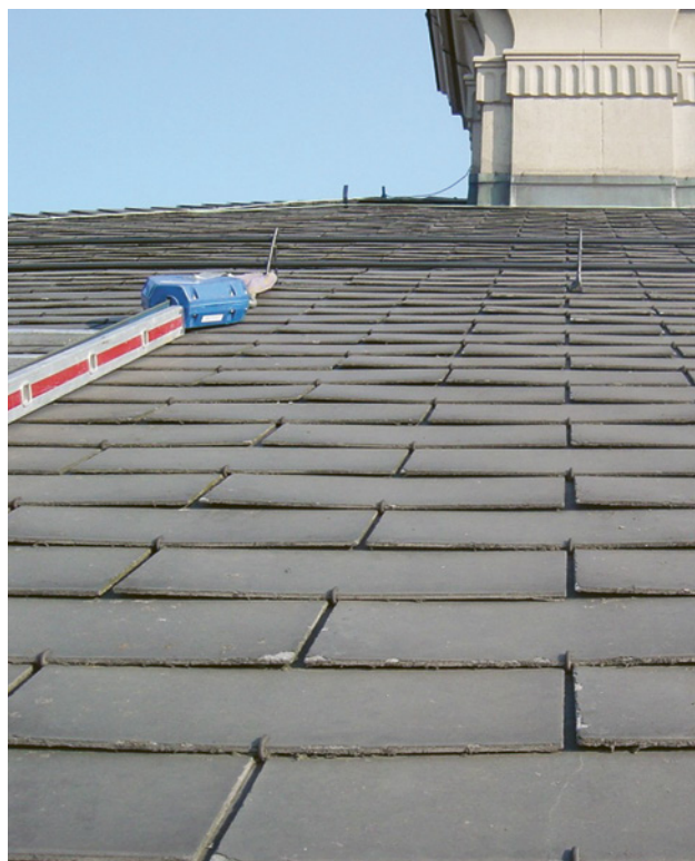
Lastre in fibrocemento contenenti amianto
