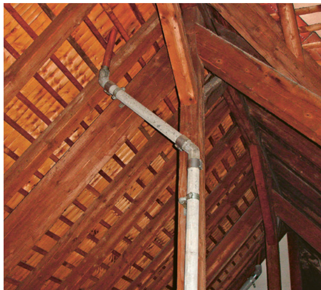
Tubazioni in fibrocemento contenenti amianto
