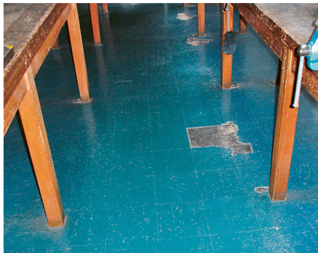
Rivestimento per pavimenti contenente amianto
