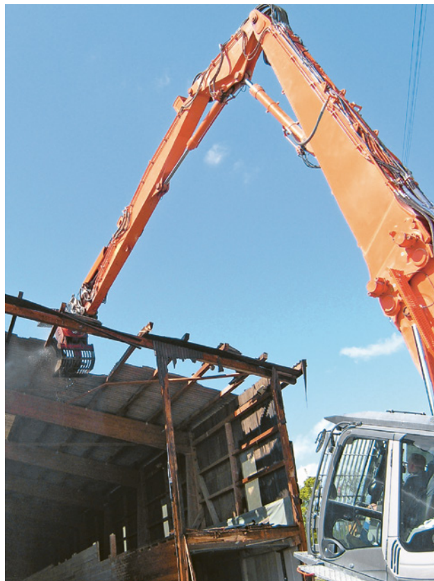
Lastre ondulate contenenti amianto
