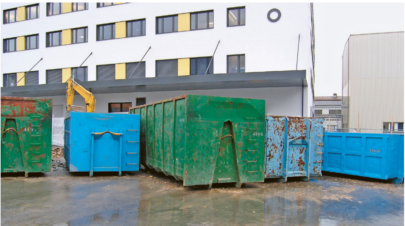
Container per amianto
