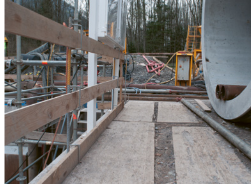
1 Les passages et voies d'accès situés au niveau des puits de départ et d'arrivée doivent être praticables en toute sécurité et sans risque de chute.
