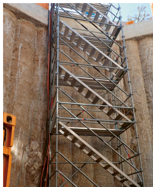
6 Des accès sûrs aux zones de travail constituent également une condition importante pour garantir la rapidité des secours en cas d'urgence.
