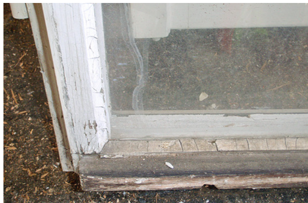
1 Stucco a base di olio di lino contenente amianto in una finestra di legno
